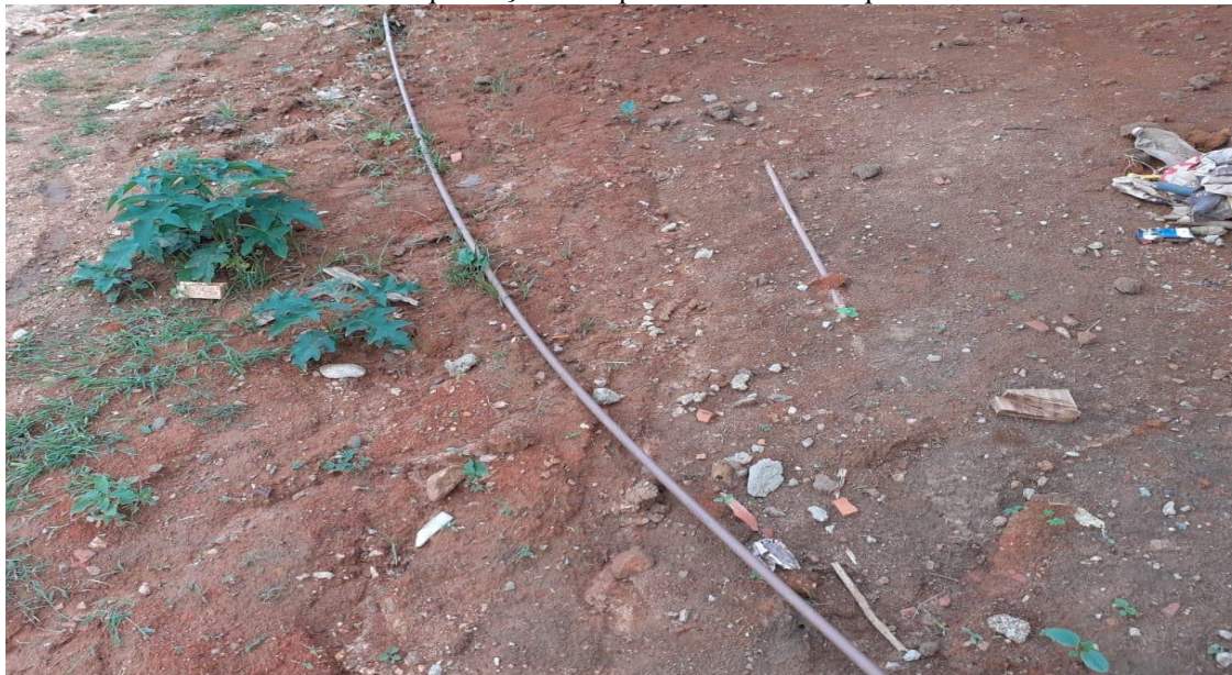
Figura 11. Em evidência encanamentos que garantem acesso a água potável às residências sem proteção adequada em via não pavimentada.
