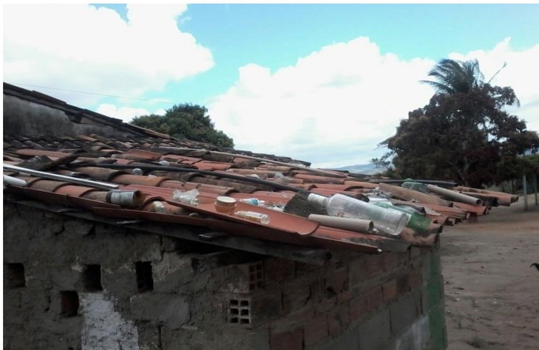
Figura 3. Vidros no telhado da casa
