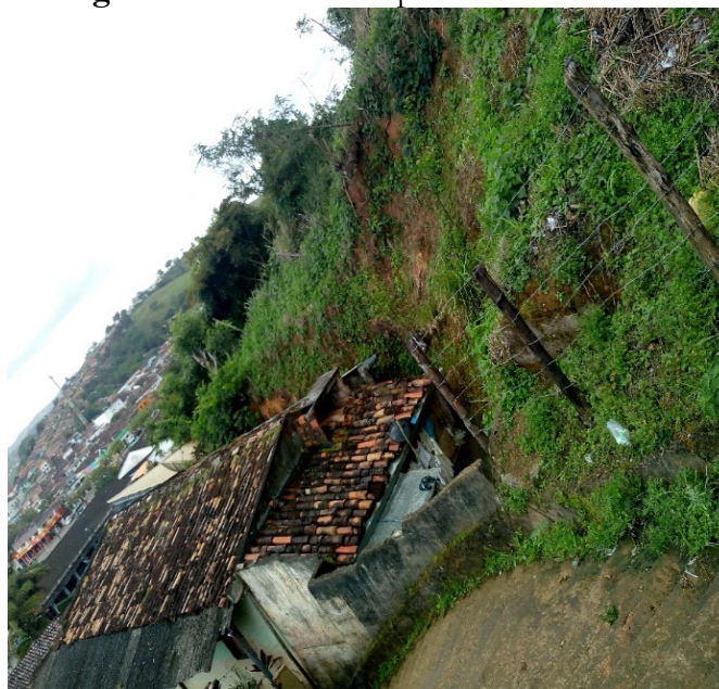
Figura 9. Moradia no sopé de talude de corte
